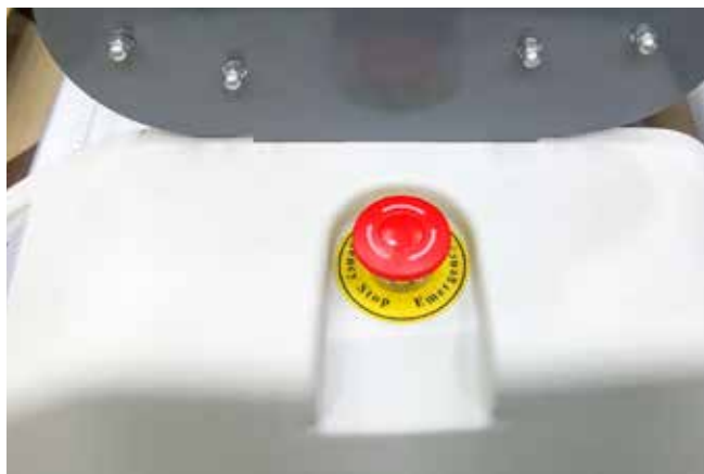
Кнопка аварийной остановки
